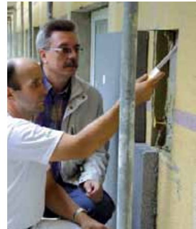
Im Zuge einer Aufdoppelung wird das bestehende Wärme - dämm-Verbundsystem zur Beurteilung der Standsicherheit an repräsentativen Stellen geöffnet. © Anja Schlamann, Köln/Leipzig, DE
